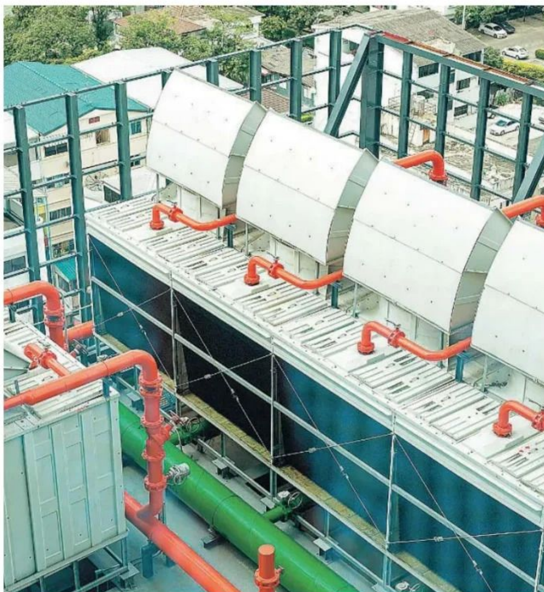
Las grandes granjas digitales no pueden usar ventiladores, sino que refrigeran con agua como en este sistema chiller de la imagen
